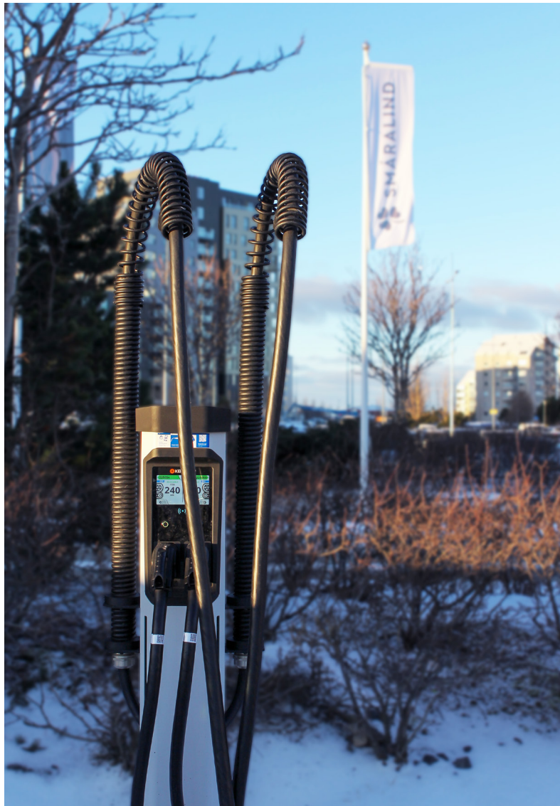
Hraðhleðslustöð við Smáralind
